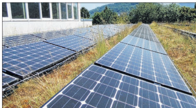
Die Solaranlage auf dem Dach des Muttenzer Hallenbades produziert umweltverträglichen Strom.
