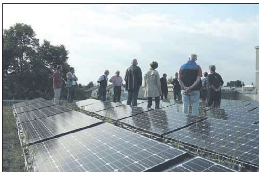
Die Solaranlage auf dem Hallenbad in Muttenz produziert seit Sommer 2014 Strom für 24 Haushaltungen.
