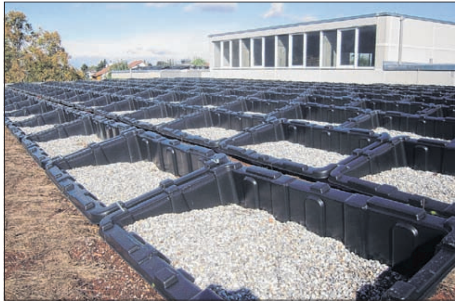
Auf dem Dach des Hallenbades sind 307 Solar-Unterkonstruktionen eingerichtet worden.
